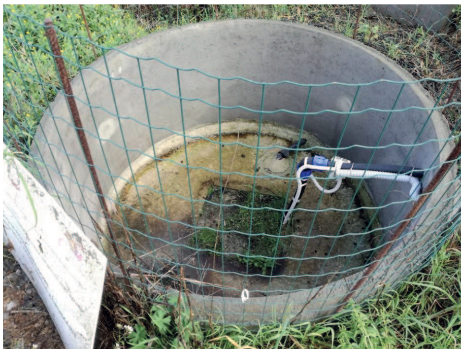
Figura 10. Vasca di accumulo, in calcestruzzo, delle acque reflue trattate dal letto HF.
